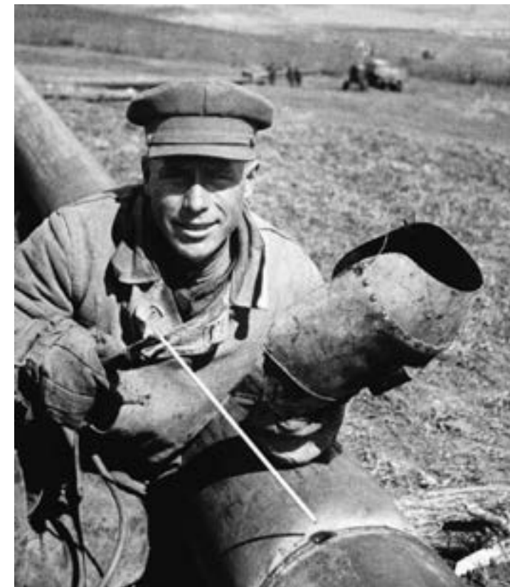
Лучший сварщик 1-го района строительства газопровода Саратов – Москва Н. А. Байдин. Саратовская область. 1945
