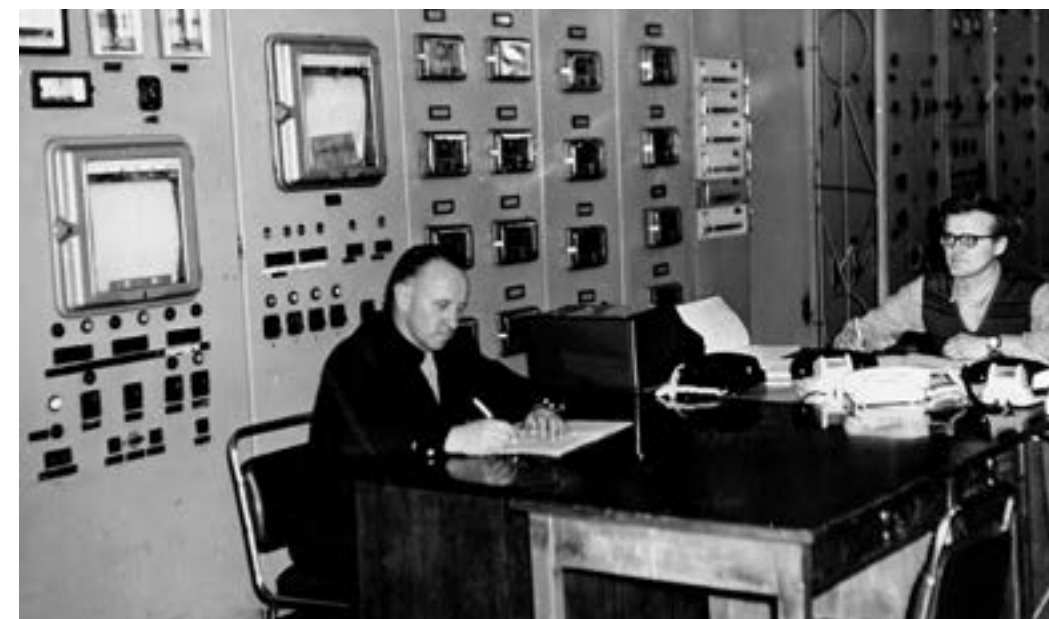
Турбокомпрессорный цех (ТКЦ) Петровского ЛПУМГ
