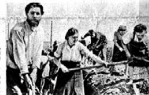
В строительстве газопровода Саратов—Москва принимают участие жители сёл и городов, расположенных вдоль его трассы.
