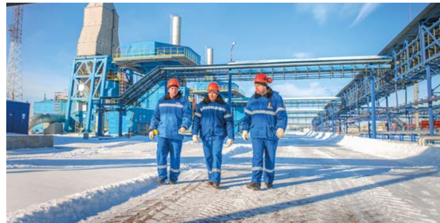
Компрессорная станция «Новопетровская». 2018
