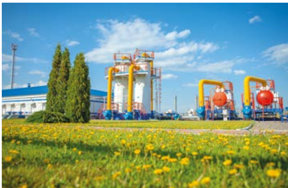
Газораспределительная станция «ГРС-2А» Сторожёвского ЛПУМГ. 2018
