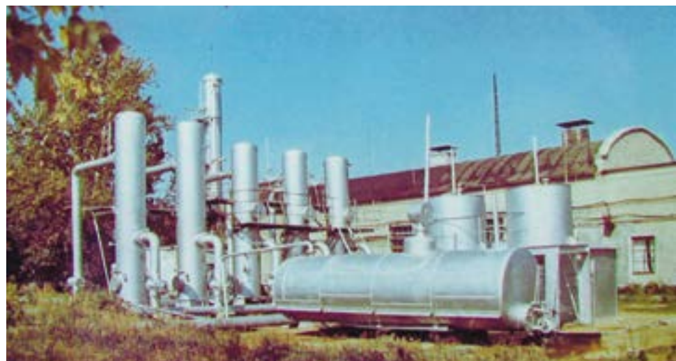
Цех осушки Кологривовской компрессорной станции. 1980
