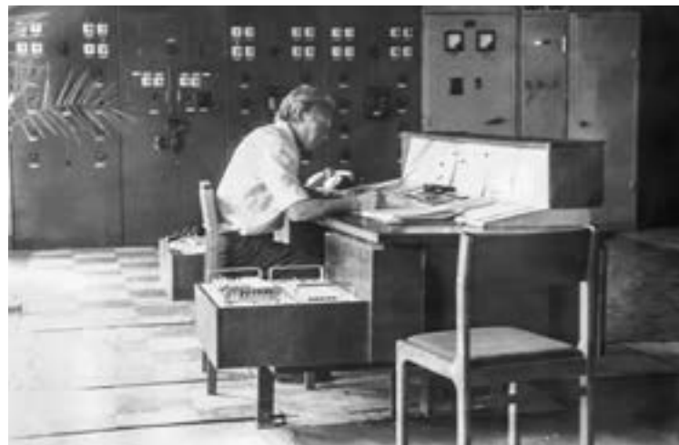
Главный щит управления КС-25
