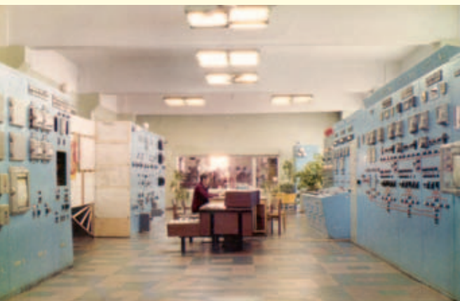
Главный щит управления. 1983 г.
