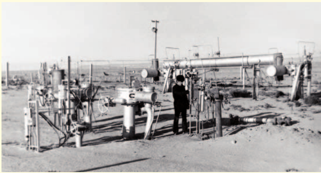
Проверка функционирования дистанционного управления кранами
