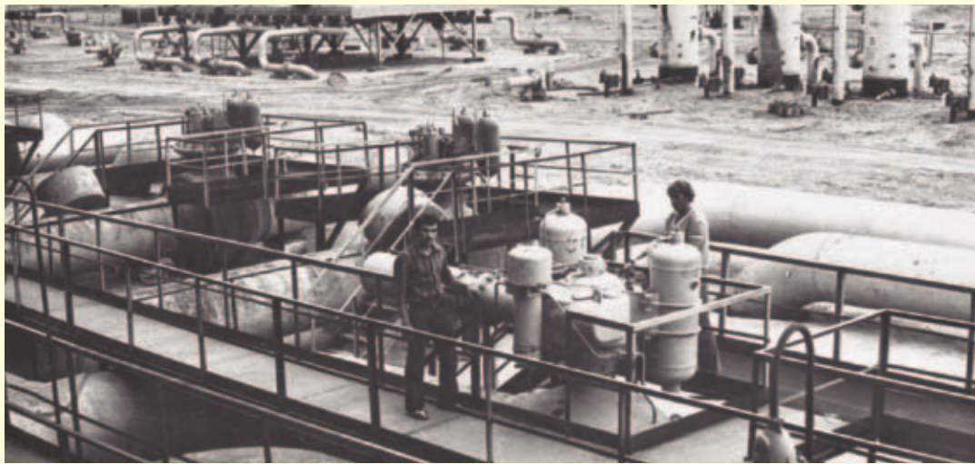
Освоение импортного оборудования. КС «Бейнеу»
