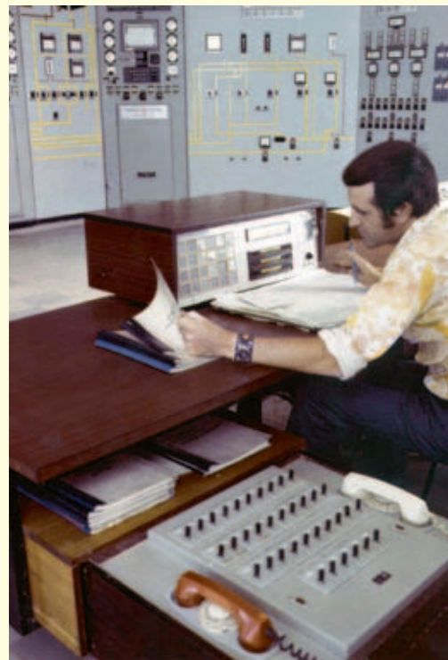
Главный щит управления КС «Акчалок». Узбекистан
