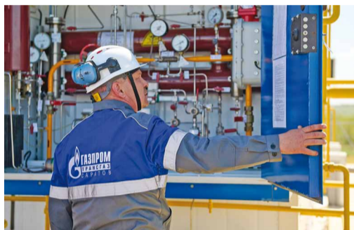
Каждый узел станции – под контролем оператора
