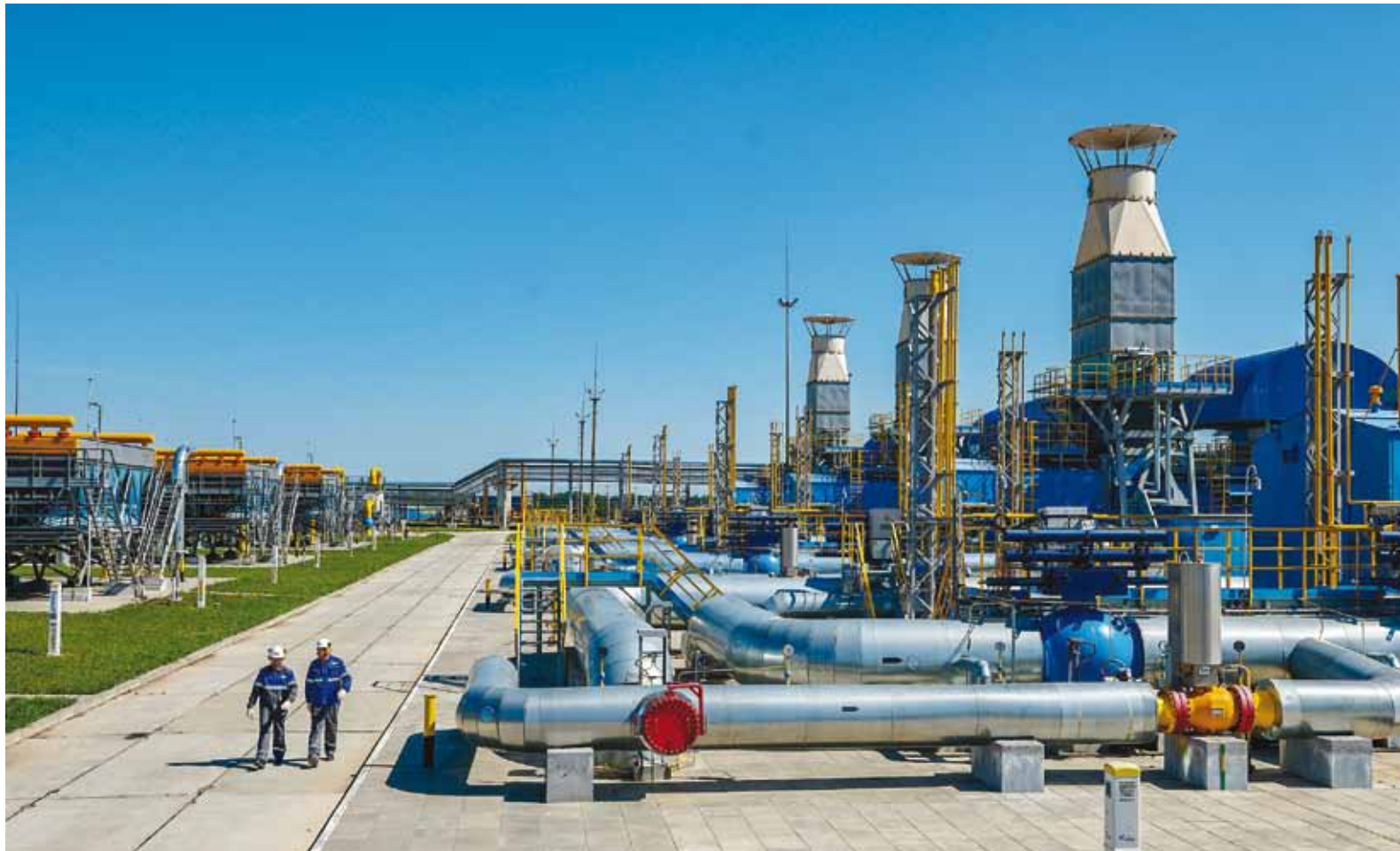
Компрессорный цех № 2 Балашовского ЛПУМГ
