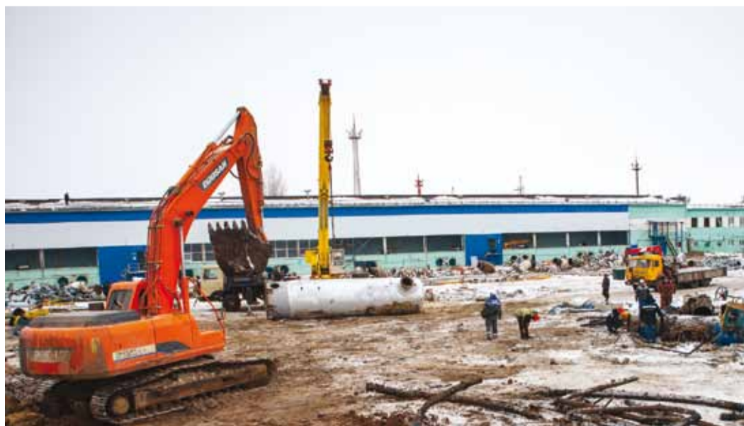
Уже через несколько недель строительная площадка будет готова к началу работ по монтажу оборудования
