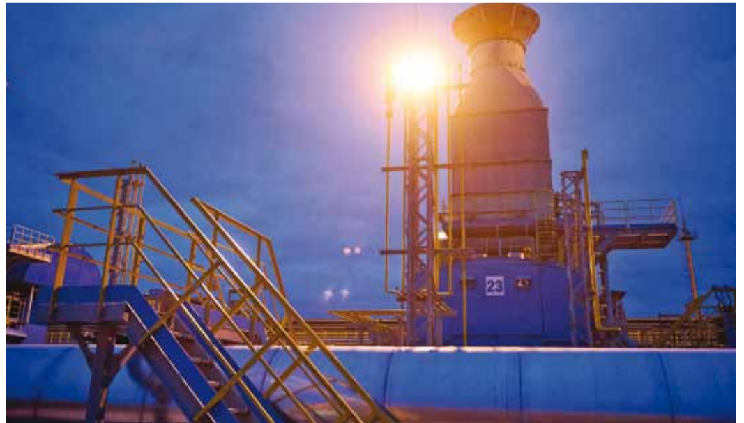
Газоперекачивающий агрегат № 23 компрессорного цеха № 2 Балаиловского ЛПУМГ
