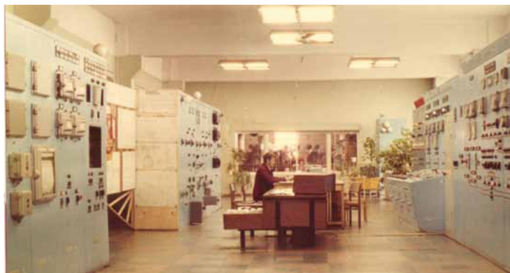
Главный щит управления Приволжского ЛПУМГ. 1975 г.
