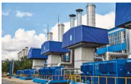
Компрессорная станция «Александров Гай»
