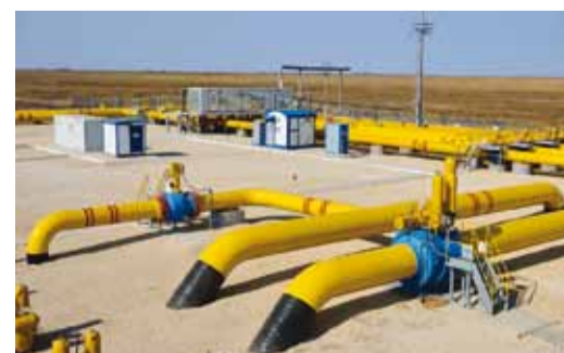
Газоизмерительная станция САЦ 4-К
