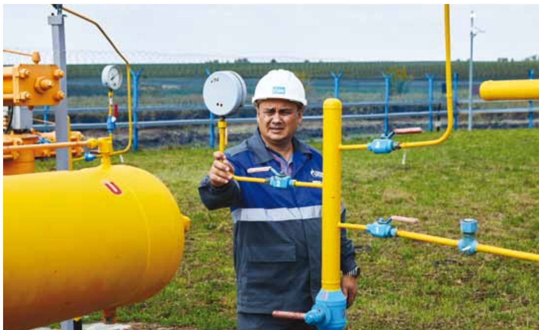
Начальник производственного отдела автоматизации Виктор Водолазов проверяет оборудование службы АИМО
