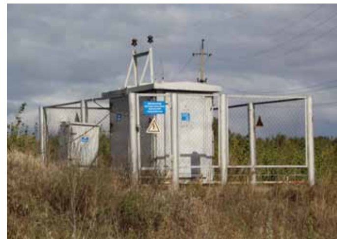
Станция катодной защиты
