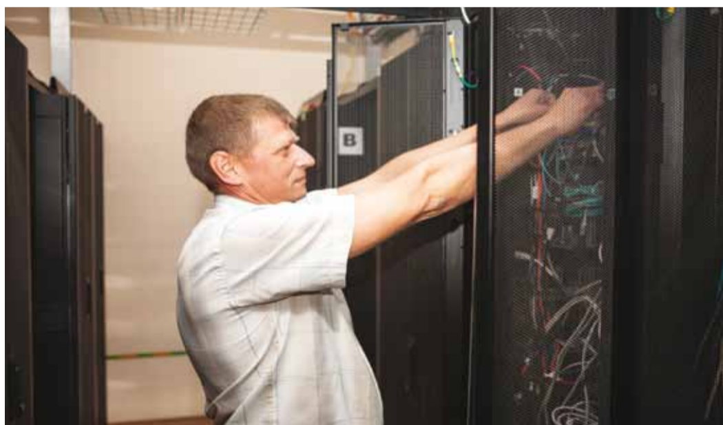
Работы на серверном оборудовании проводит заместитель начальника отдела системно-технической инфраструктуры Алексей Рыжков
