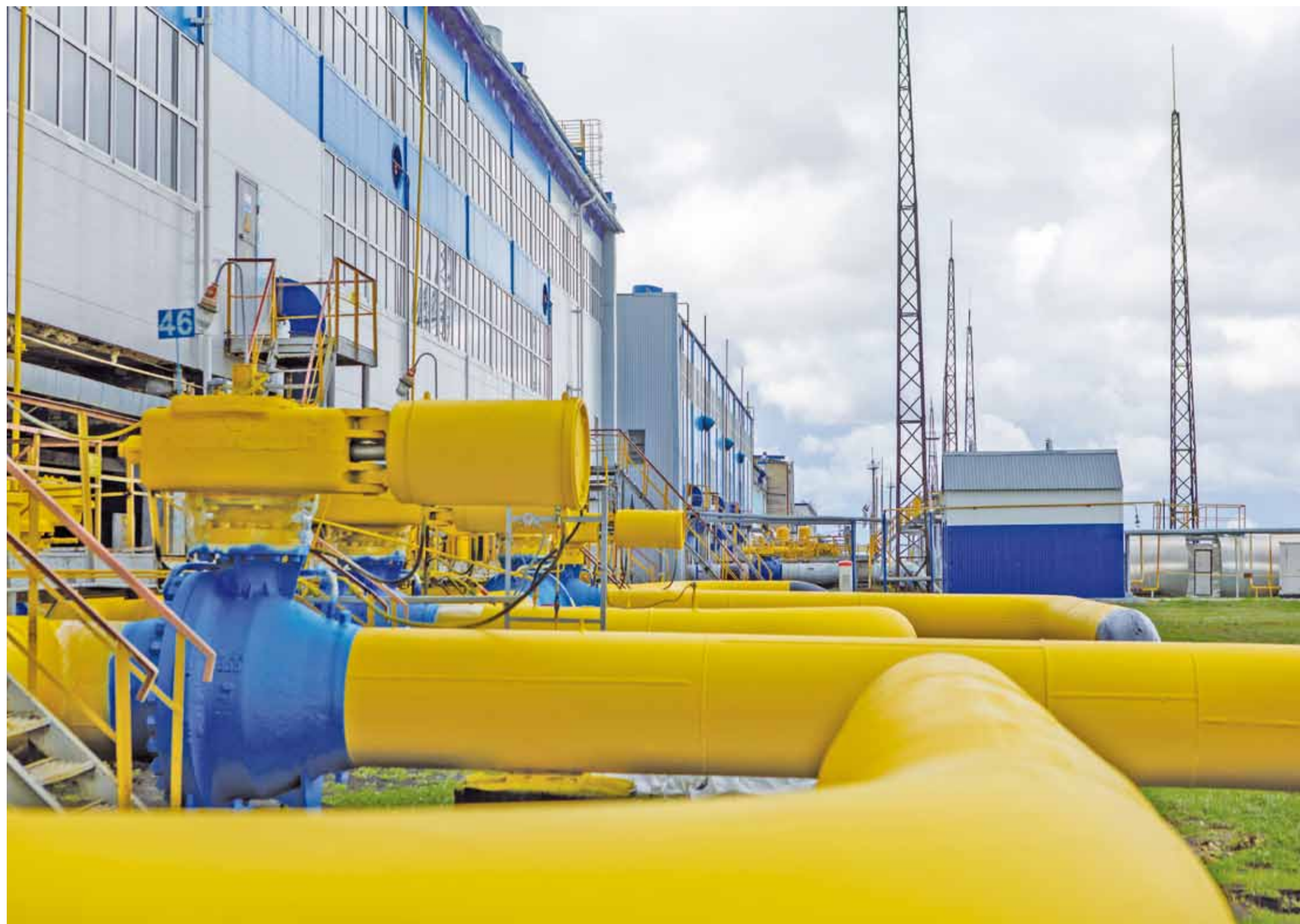
Компрессорный цех №1 Александровогайского ЛПУМГ
