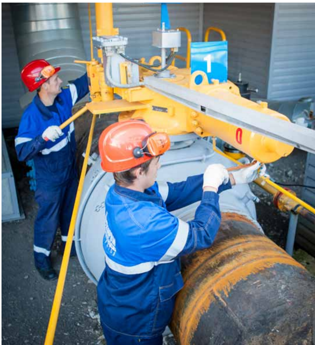
Машинисты технологических компрессоров Н.В. Белков и М.Е. Долбилин проводят работы на кране Ду700
