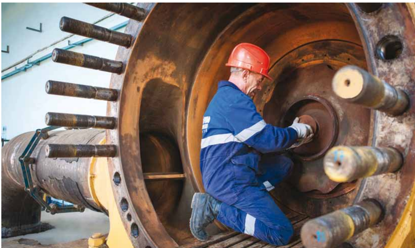
Слесарь по ремонту ТУ КС Виктор Лузановский устанавливает оптекатель на рабочее колесо нагнетателя
