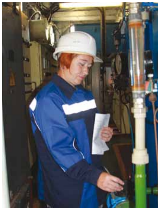
Светлана Бурдыкина контролирует параметры работы очистных сооружений
