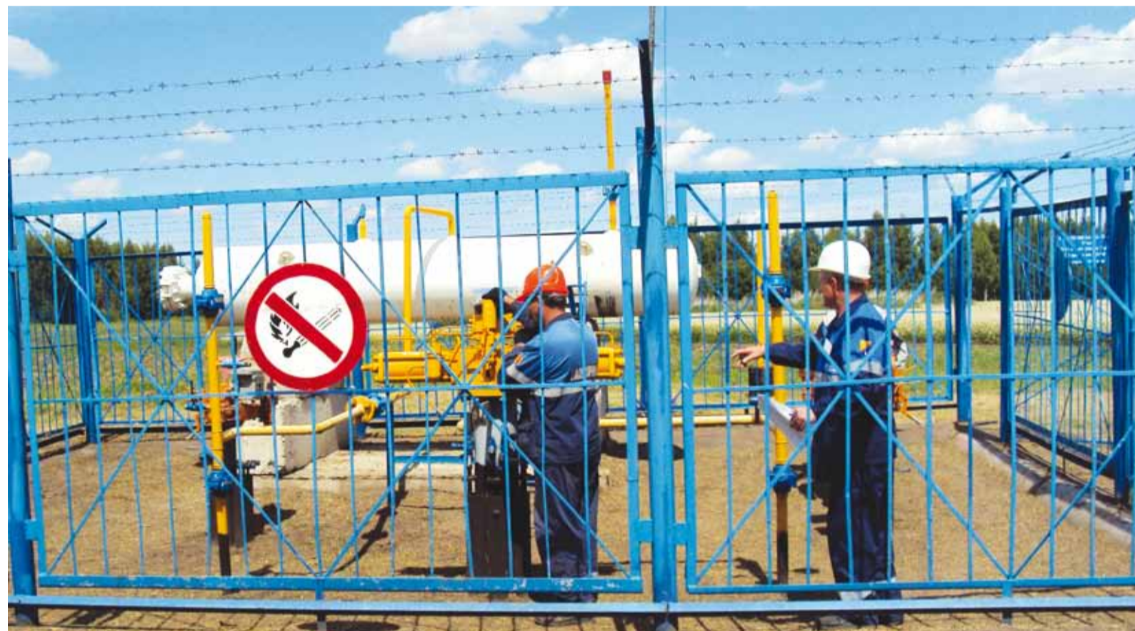
Первый шаг по ликвидации условной аварии - перекрытие запорной арматуры
