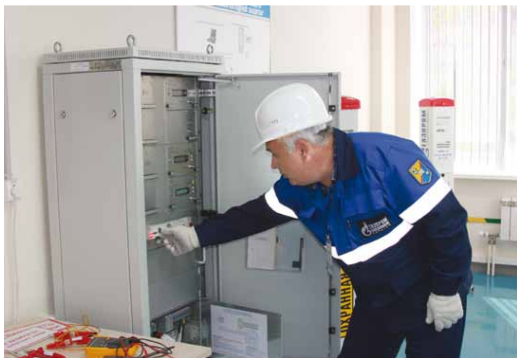
Текущий осмотр установки катодной защиты
