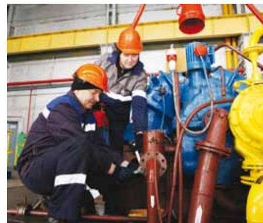
Машинисты технологических компрессоров Валерий Илюшин(слева) и Александр Чекулаев производят ревизию регулятора производительности главного масляного насоса турбоагрегата ГТ-750-6
