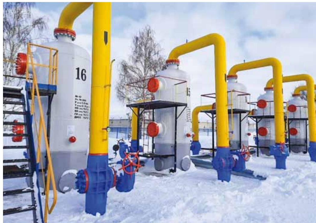
Пылеуловители компрессорного цеха №1 сверкают свежей краской
