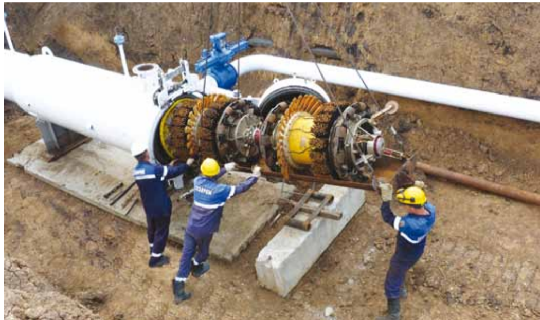
Огневые будни ЛЭС Сторожевского ЛПУМГ
