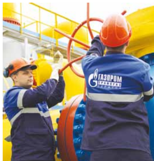
Закрытие входного крана пылеуловителя №1
