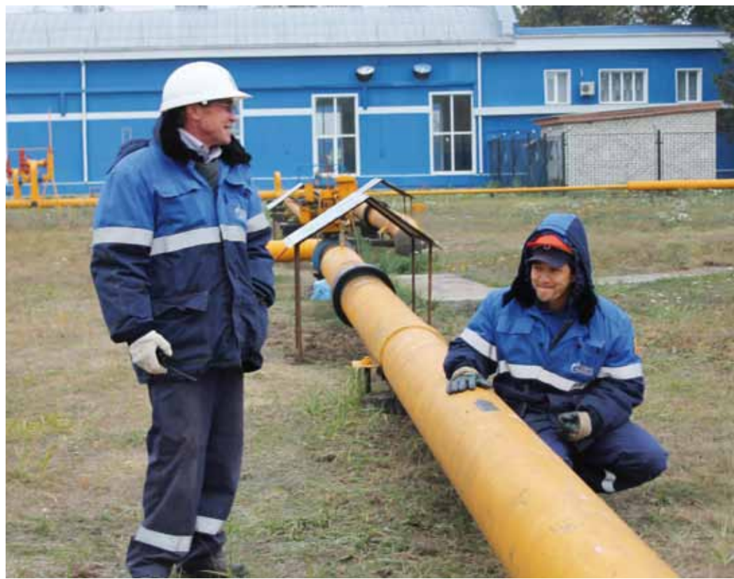
Инженер службы ГРС Андрей Свечников и слесарь Руслан Мамлеев несут дежурство при проведении ВТД
