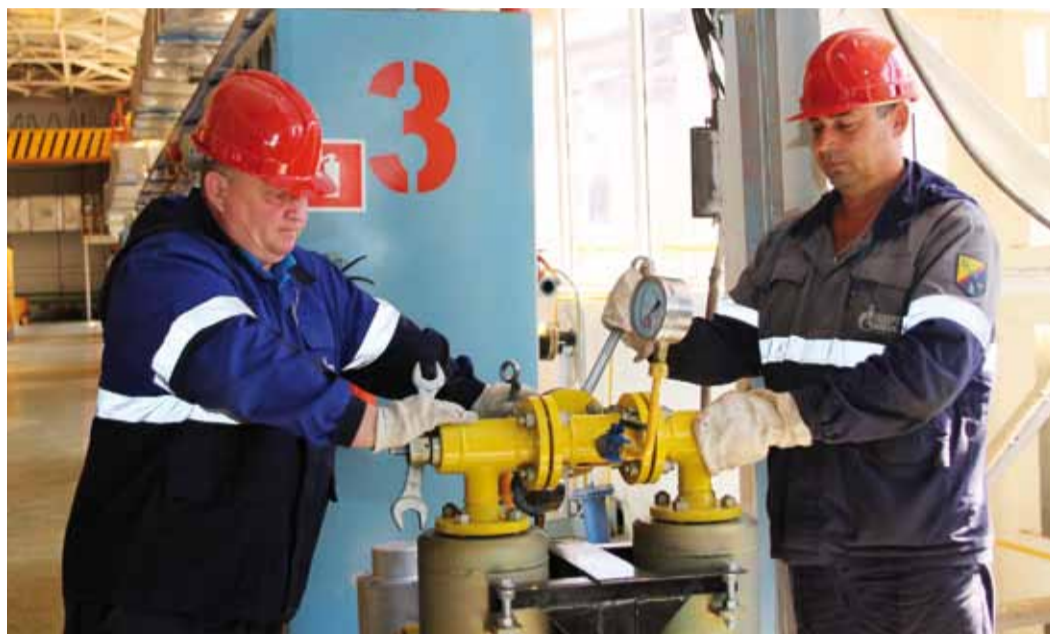
Машинисты ТК С.Трудов и В.Усков проводят ревизию оборудования компрессорного цеха
