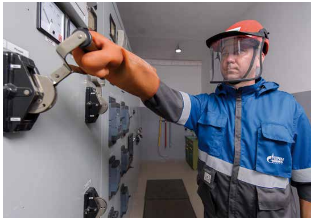
Оперативные переключения в ЗРУ и КТП – одни из самых ответственных видов работ
