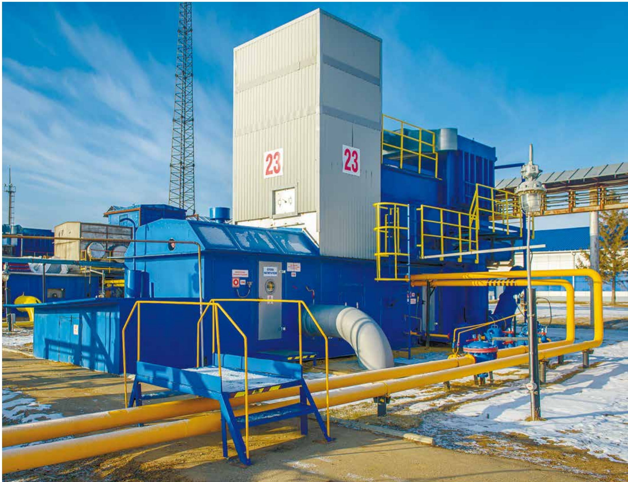
ГПА-Ц-6,3 №23 компрессорного цеха №2 Сторожевского ЛПУМГ
