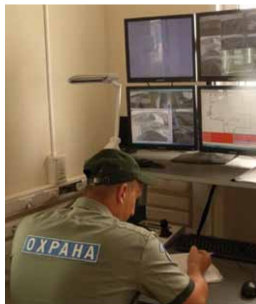
Новый комплекс ИТСО в работе
