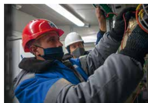
Настройка агрегатной автоматики
