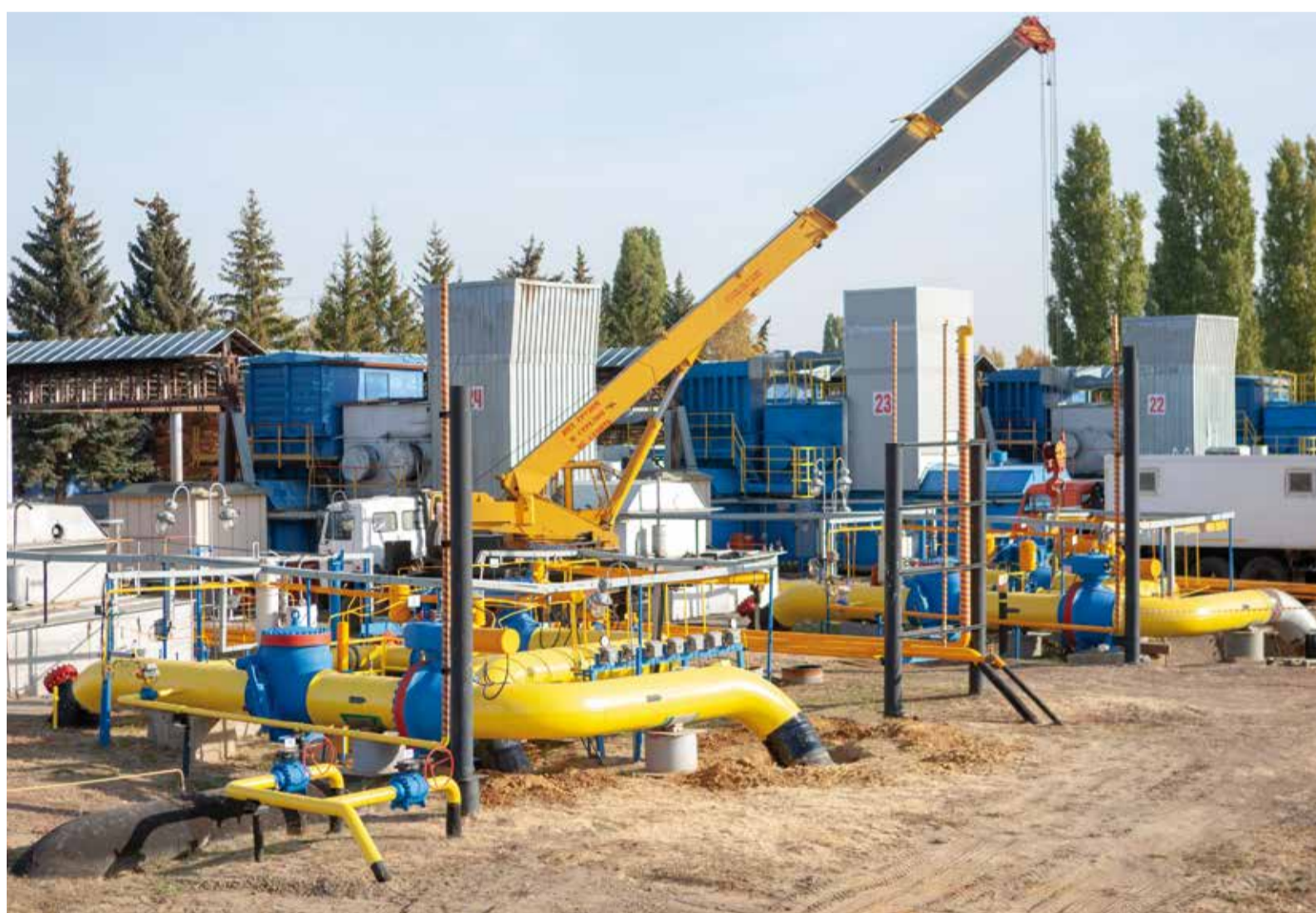
Компрессорный цех № 2 используется для закачки газа в подземное хранилище
