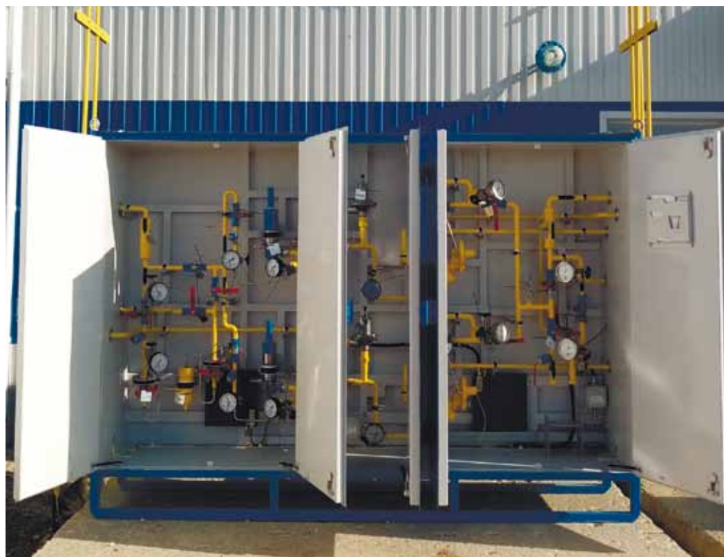
Редуцирующий пункт ГРС «Союз» Александровогайского ЛПУМГ
