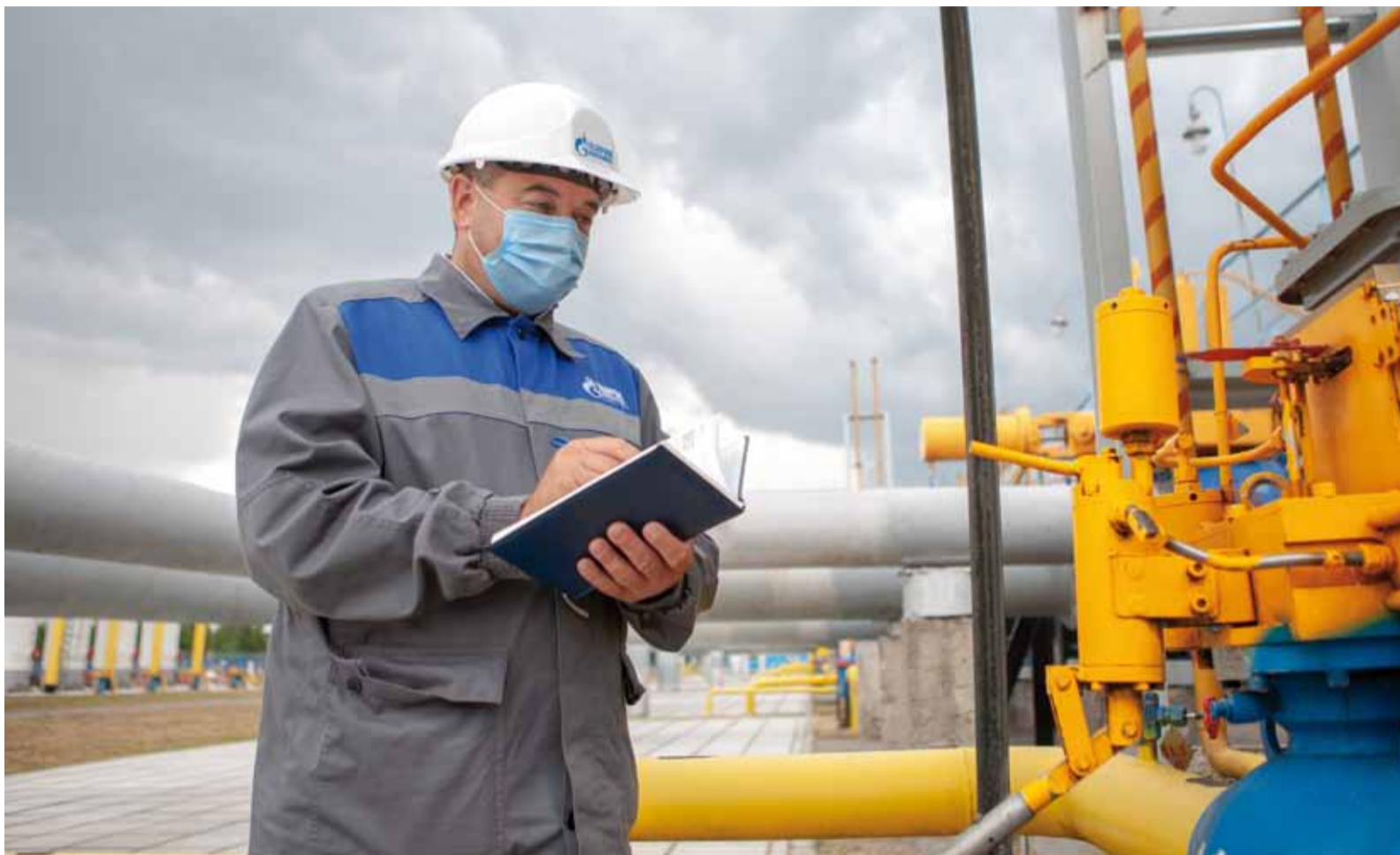
Ведущий инженер производственного отдела по эксплуатации компрессорных станций Николай Ерастов проверяет состояние оборудования КЦ-3 Мещерского ЛПУМГ
