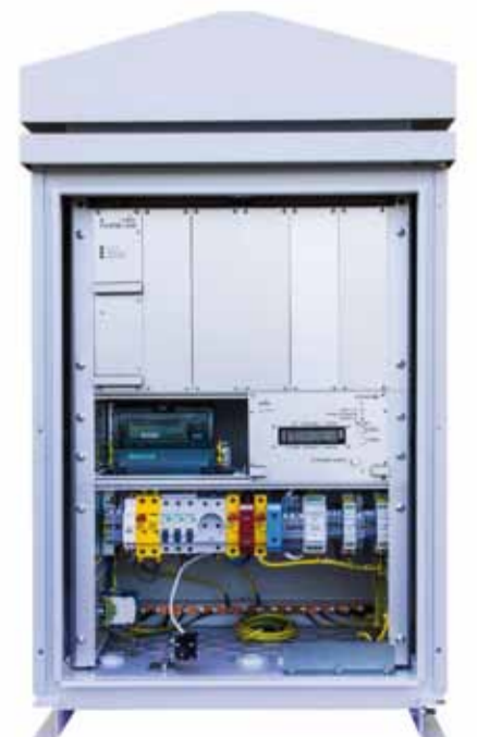
■ Станция катодной защиты
