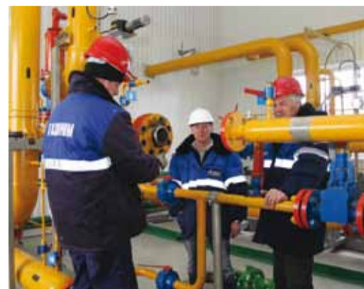
Замена регуляторов на блоке топливно-пускового газа
