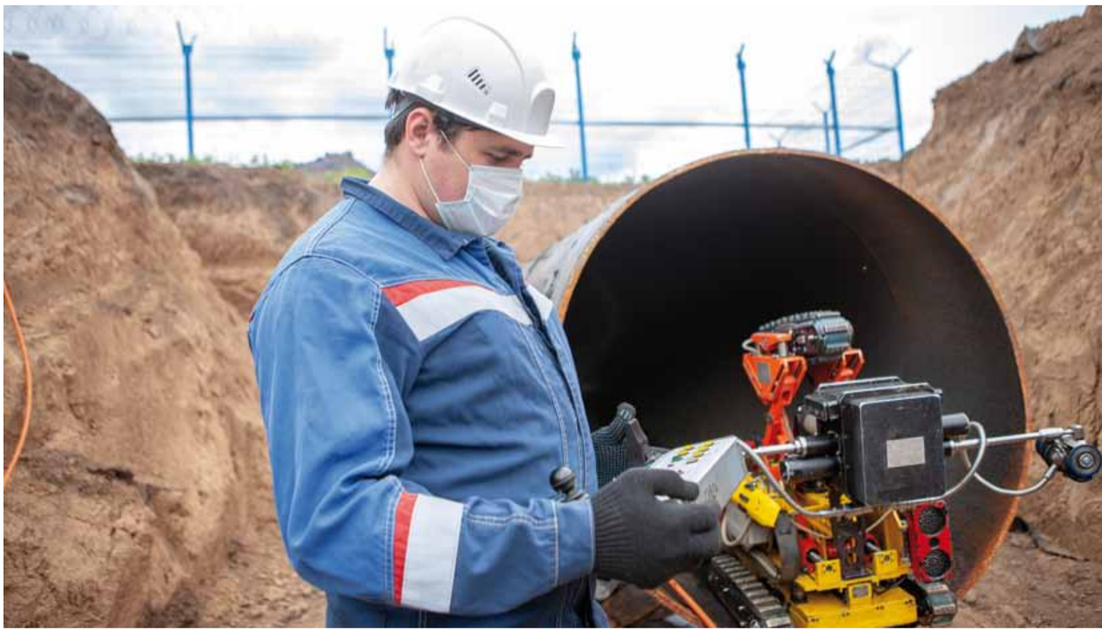
Передвижением робота внутри технологических трубопроводов управляет оператор с помощью специального джойстика
