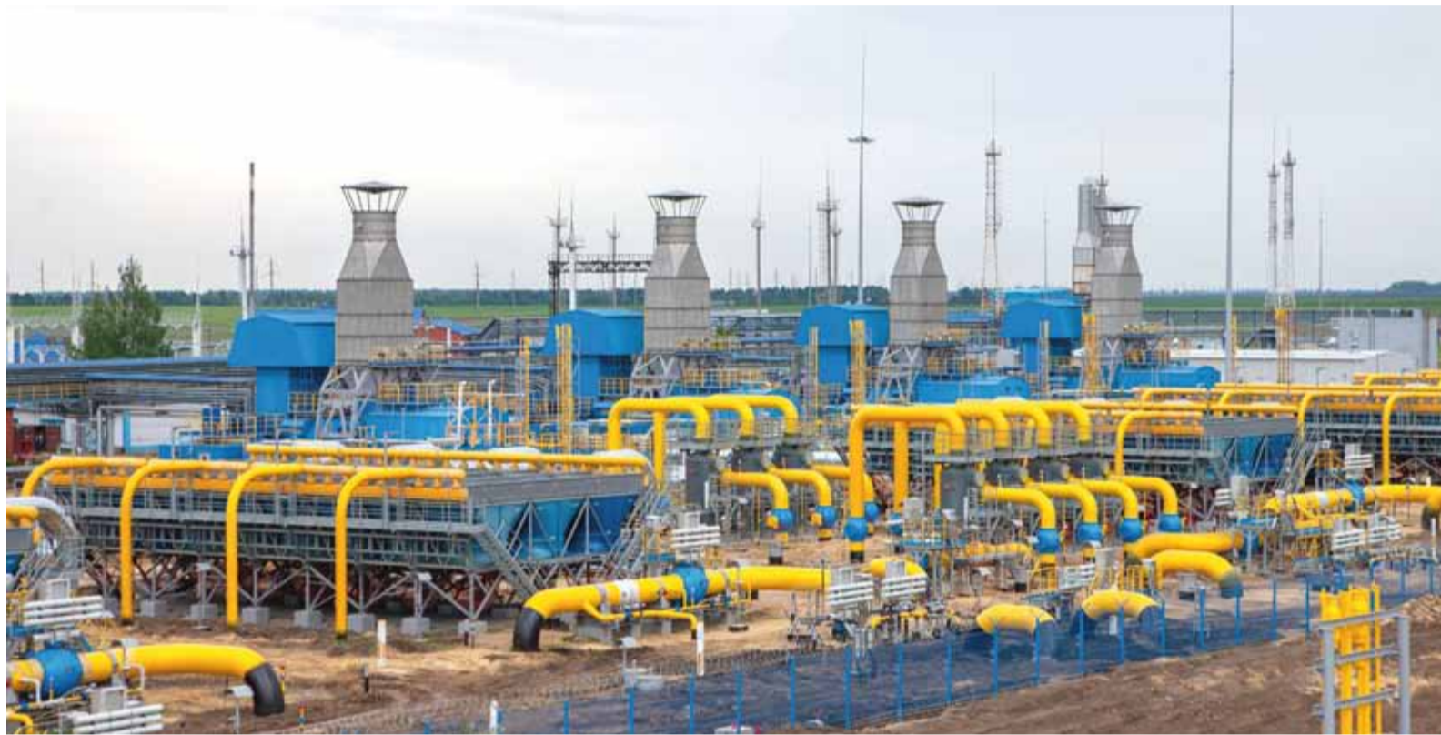
В рамках реконструкции КЦ - 4 в Петровском ЛПУМГ установлено 6 газоперекачивающих агрегатов суммарной мощностью 36 МВт
