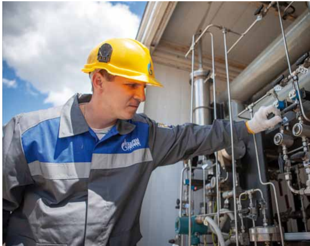
Оператор ГРС «Весна» Александр Спиренков контролирует работу автоматической одоризационной установки
