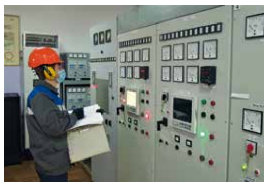
Машинист ДВС 5 разряда Вадим Плево контролирует параметры работы моторгенератора 11 ГД-100
