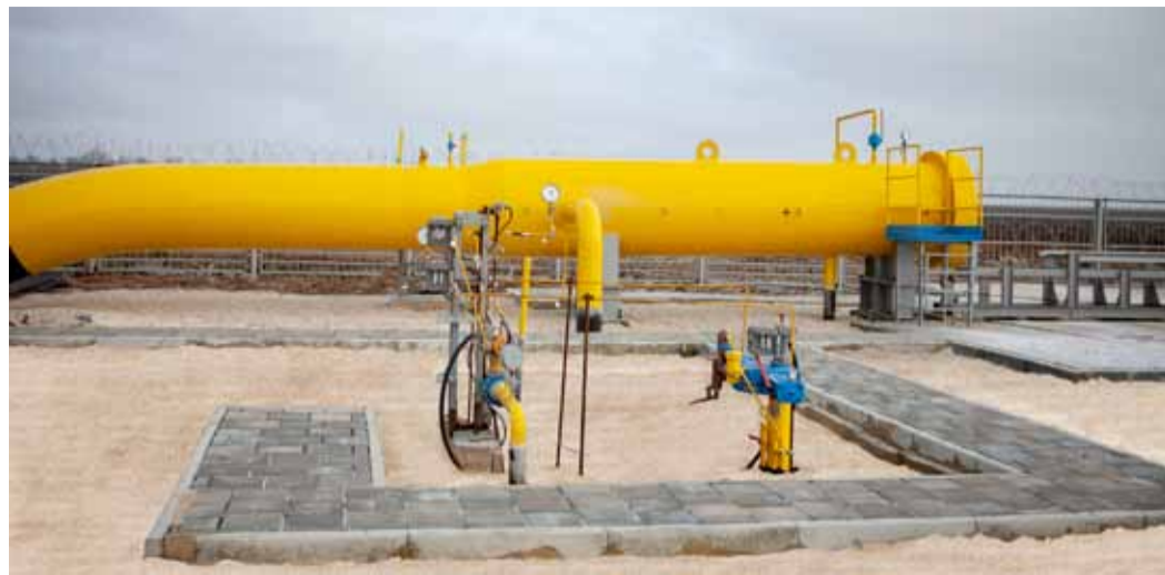
Стационарные камеры запуска и приема очистных и диагностических устройств заметно облегчают проведение ВТД
