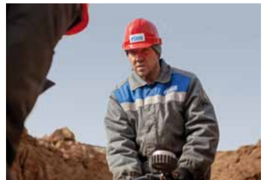
Контроль давления в ВГУ
