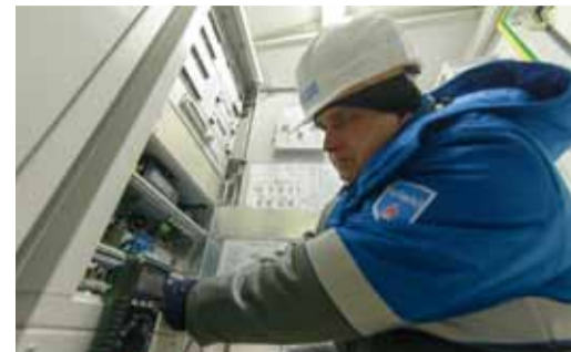
Контроль технического состояния оборудования.
