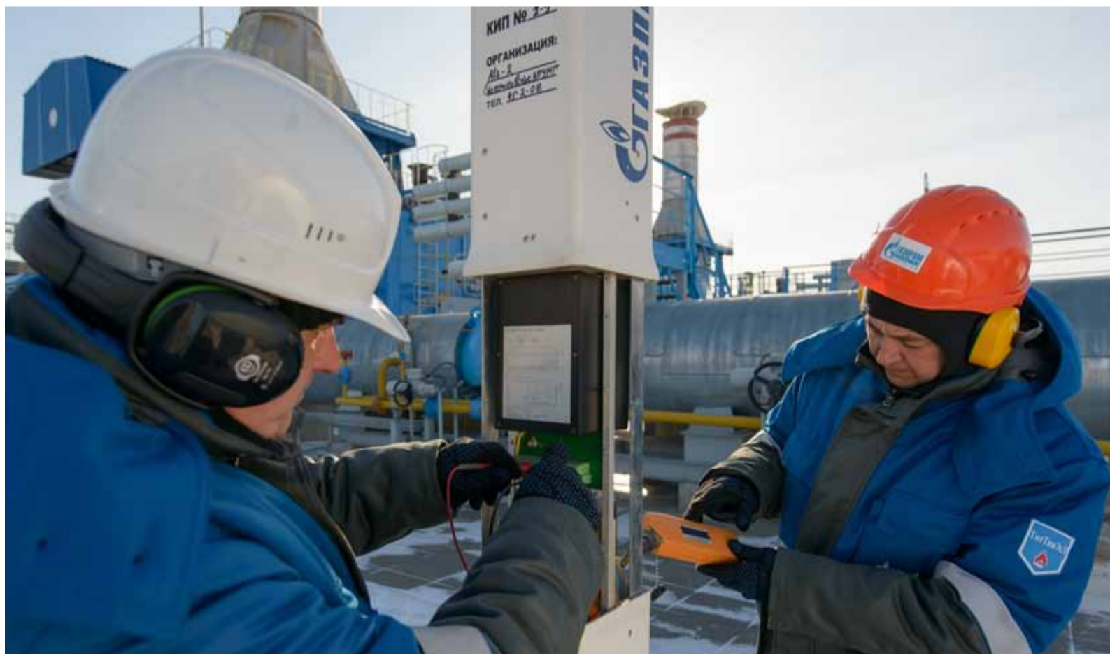
Специалисты участка защиты от коррозии Екатериновского ЛПУМГ проводят углубленный мониторинг параметров ИПП в устройствах сбора и передачи данных НГК-ИПП-СМ
