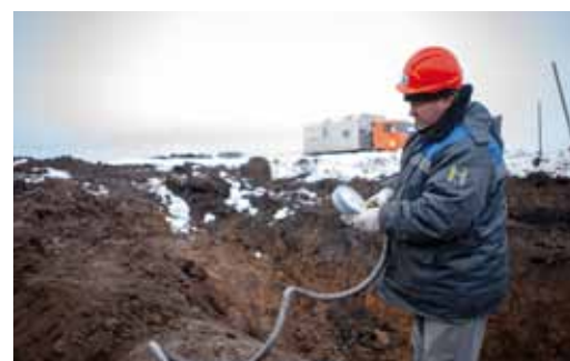
Контроль давления в герметизирующем устройстве
