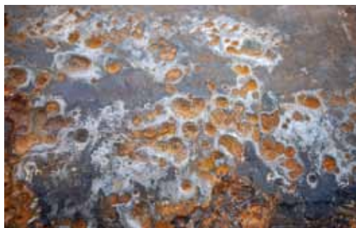
Коррозия на теле демонтированной трубы
