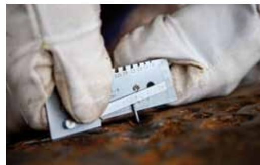
Так выглядит дефект категории А
