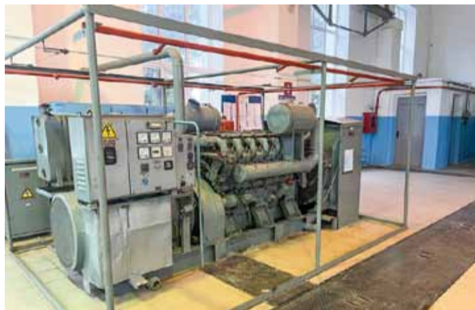
Дизельный генератор Кирсановского ЛПУМГ со встроенной буферной гибридной батареей
