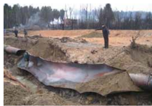
Последствия взрыва на магистральном газопроводе
