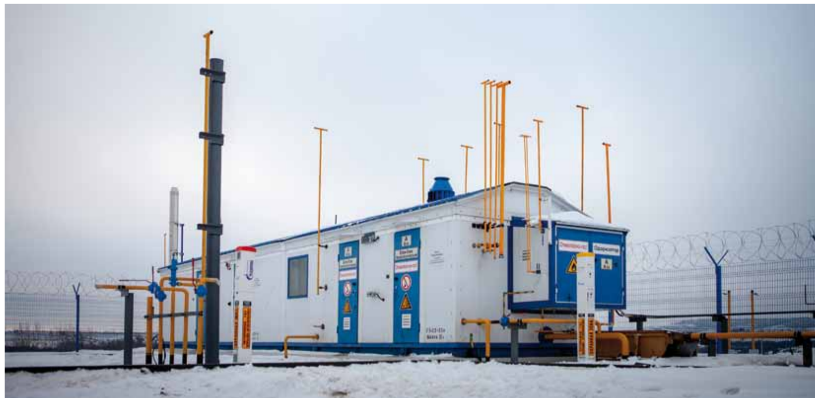
Газораспределительная станция села Широкое
