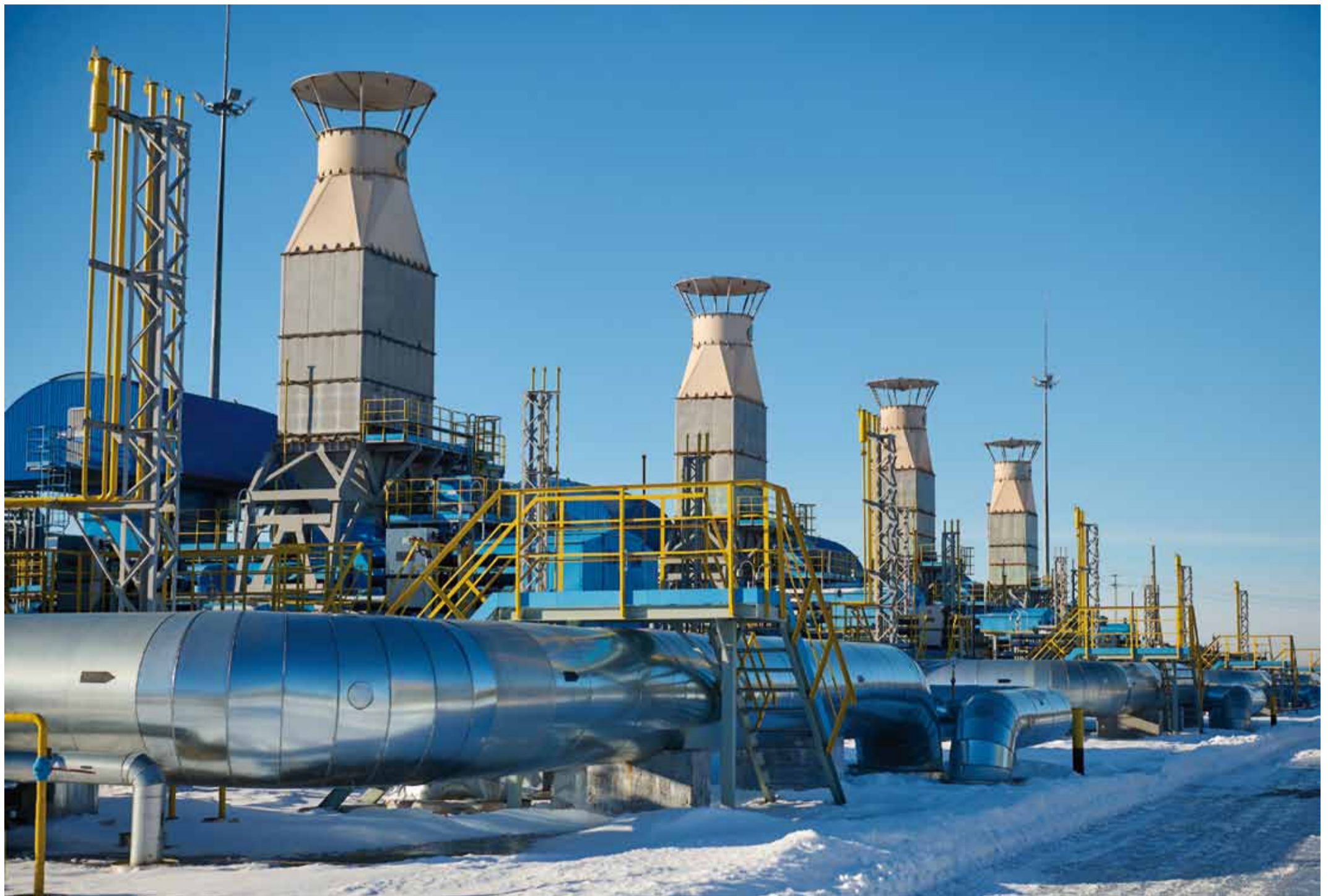
Компрессорный цех № 2 Балашовского ЛПУМГ. Фото из архива ССОиСМИ
