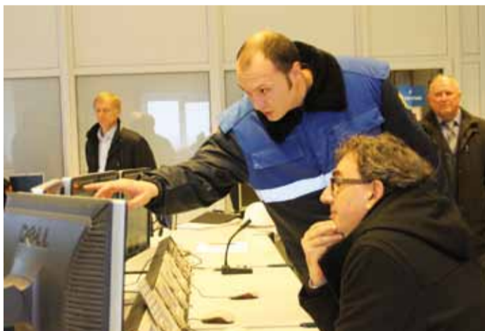
На главном щите управления КС «Новопетровская»
