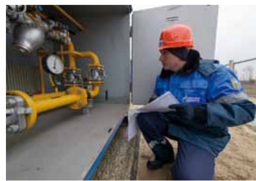
Газорегуляторный пункт - ГРС в миниатюре
