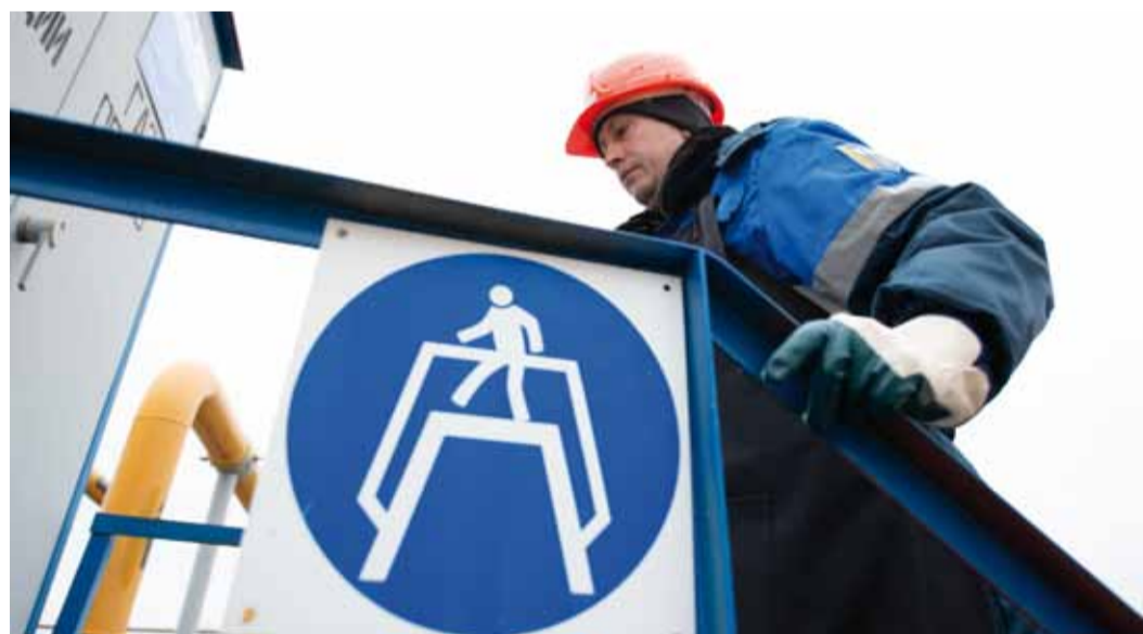
Проверка узла одоризации газа
