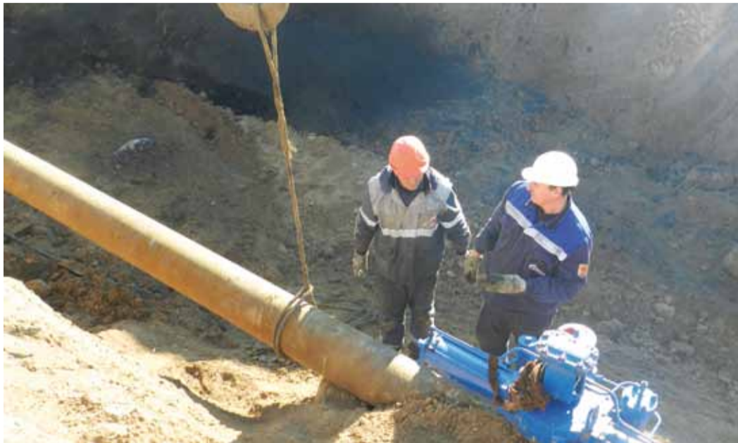
Проведение внутритрубной дефектоскопии на «САЦ-II». Линейные трубопроводчики С. Овчинников и Н. Бобров
