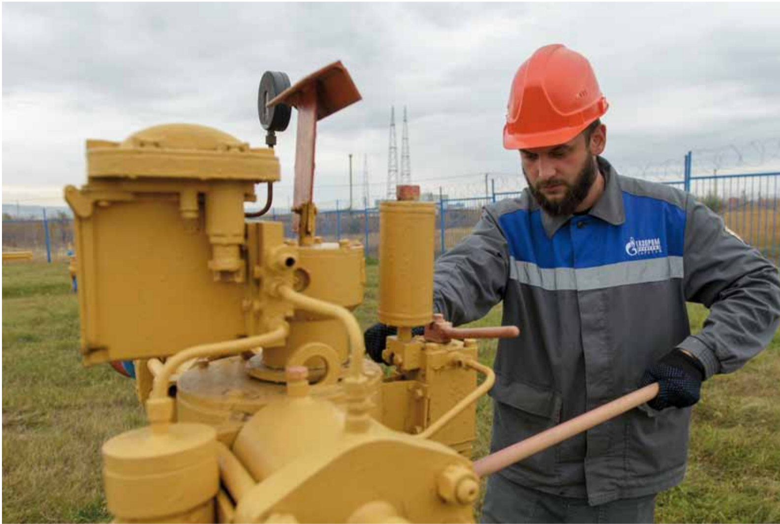
Подготовка крановой площадки к периоду отбора газа. Трубопроводчик линейный 5 разряда Сторожевского ЛПУМГ Дмитрий Аверьянов выполняет перестановку запорной арматуры
