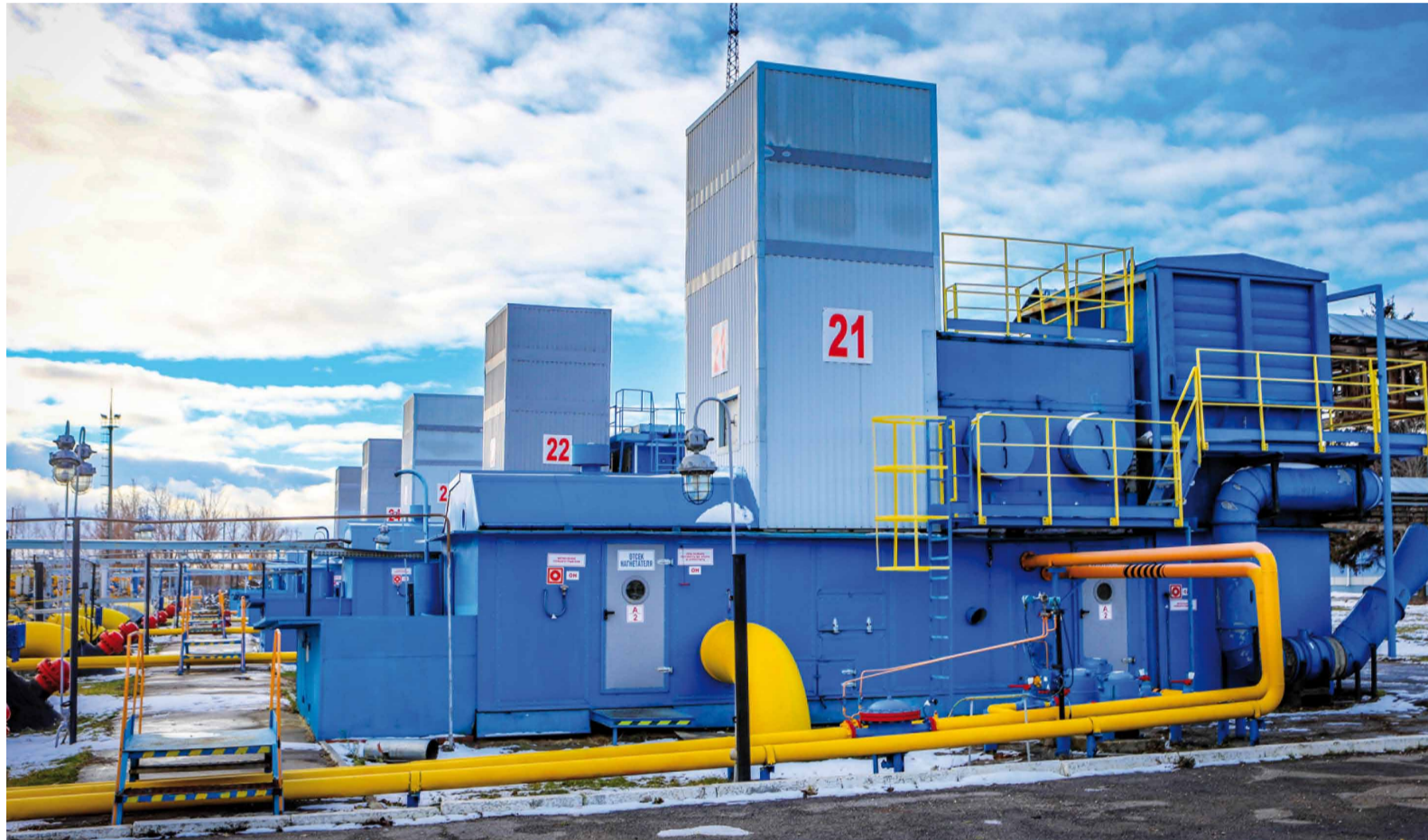
Компрессорный цех Сторожеского ЛПУМГ работает сейчас на отбор газа из ПХГ
