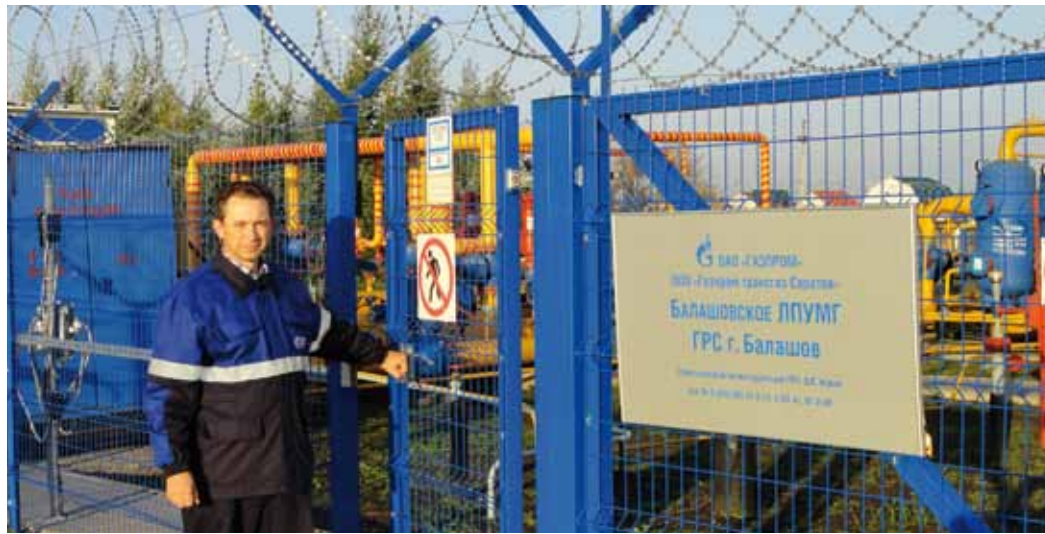
Начальник службы по эксплуатации газораспределительных станций В.Жуков на ГРС «Балашов»
