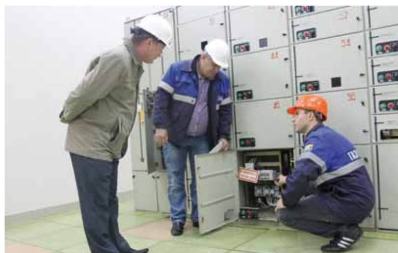
Сергей Джамирзе со специалистами службы ЭТВС Александровогайского ЛПУМГ осматривает оборудование на подстанции собственных нужд.
