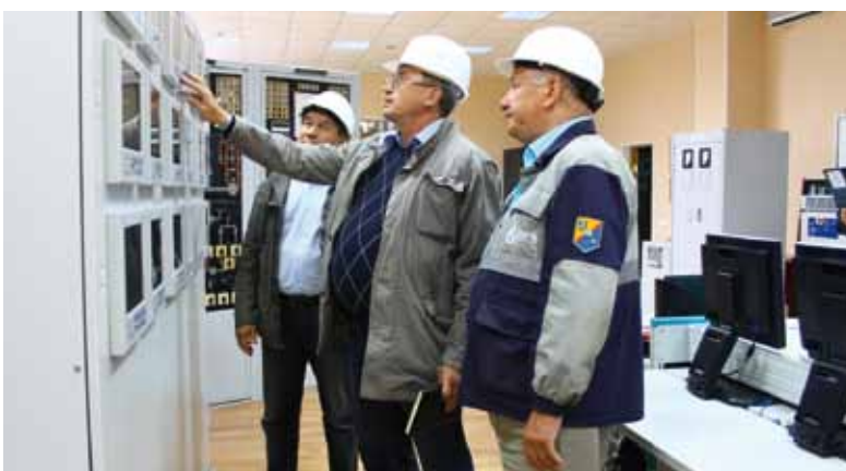
Ведущий технолог производственного отдела автоматизации и телемеханики Анатолий Иванов осуществляет проверку оборудования в компрессорных цехах Александровогайского ЛПУМГ
