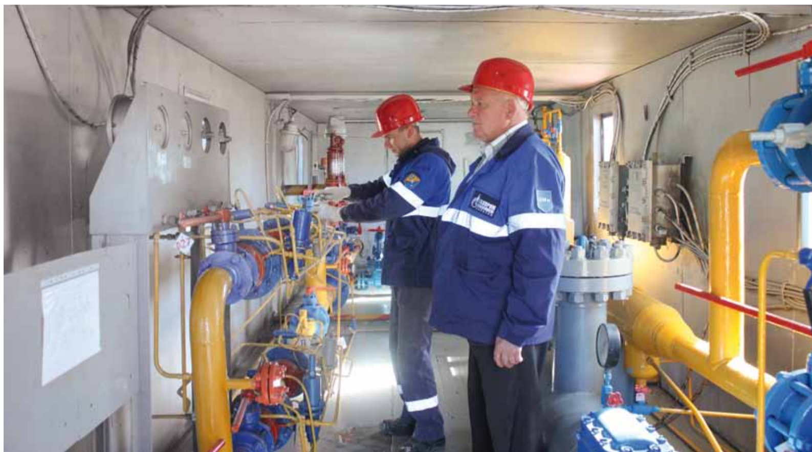
Начальник службы ГРС А. Алексеев и слесарь по ремонту и эксплуатации оборудования газовых объектов С. Борисов проводят настройку оборудования
