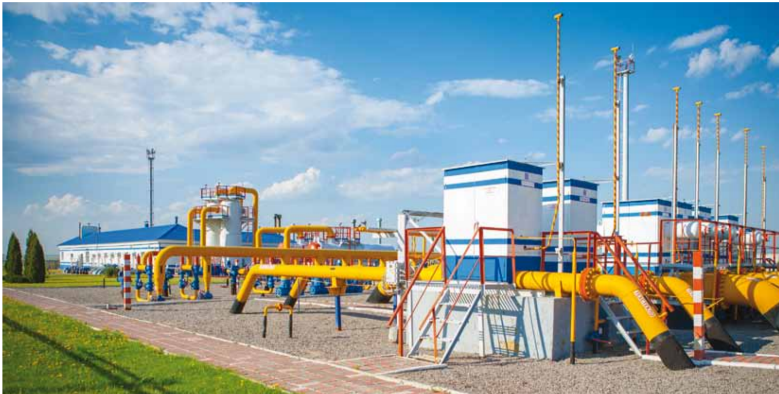
ГРС-2А обеспечивает надежное газоснабжение населения, объектов социальной сферы и промышленных предприятий Саратова
